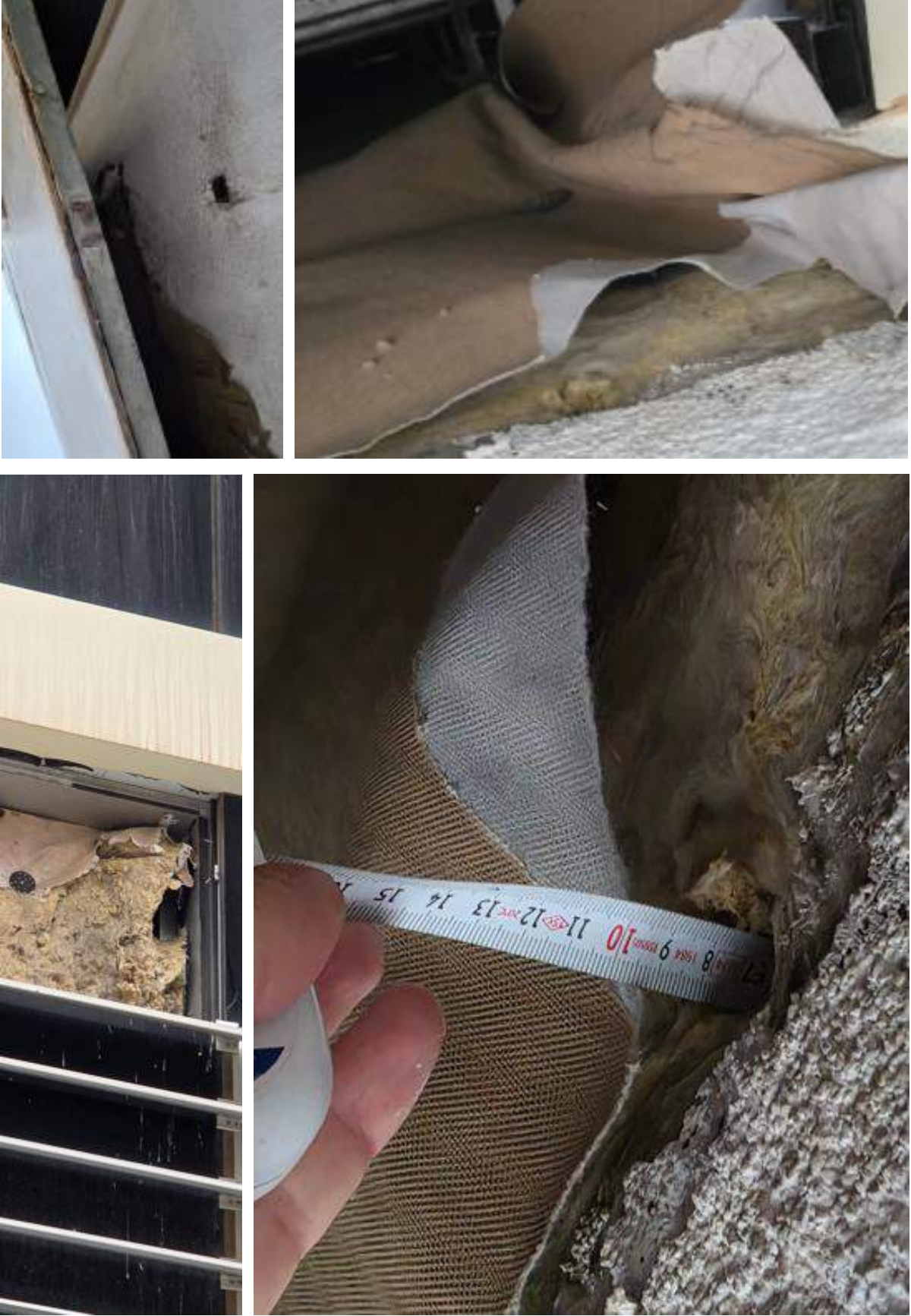
Resim 13. Kompozit Kaplamalı Duvarlarda Tespit Edilen 8cm Taşyünü Yalıtımı
