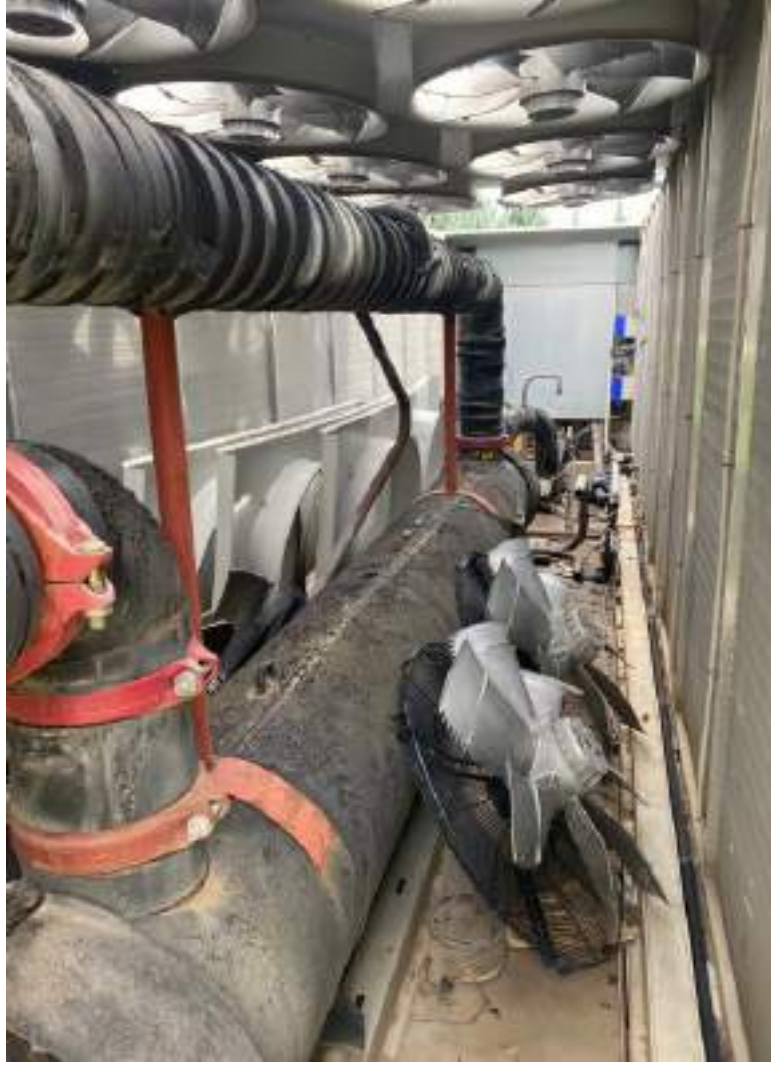
Resim 36. Arızalı Chiller İç Görünüm
