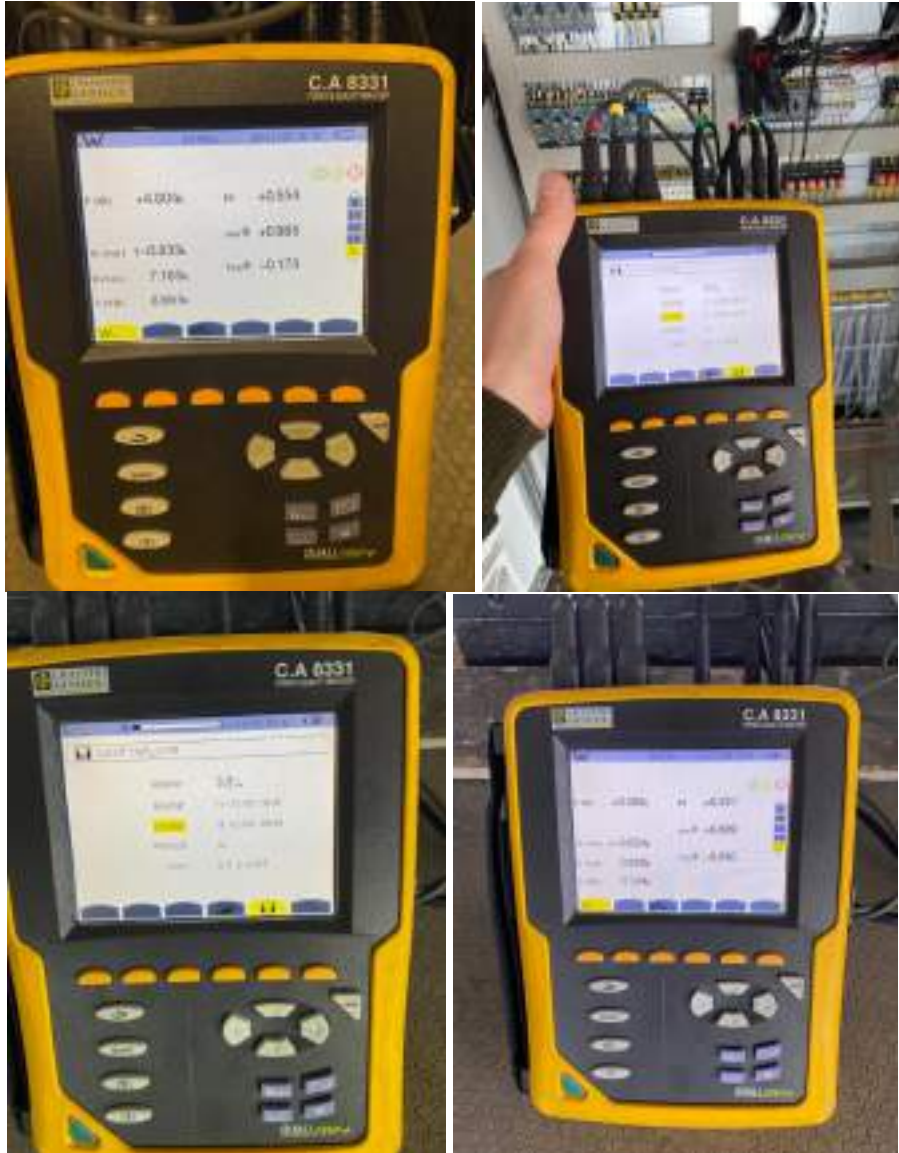
Resim 44. Havalandırma Sistemi Enerji Analizörü Ölçümü
