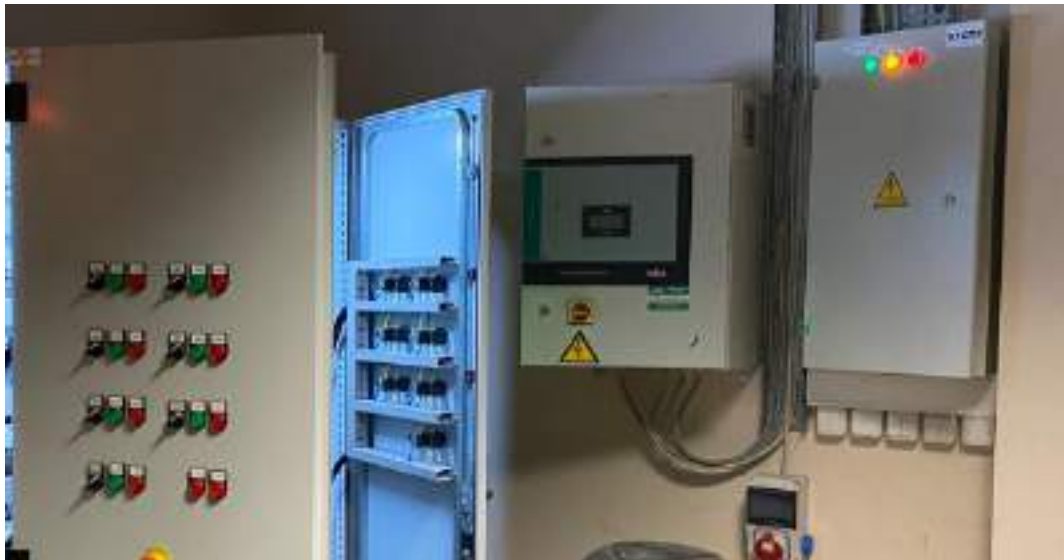
Resim 55. Pompa Frekans İnvörtörleri
