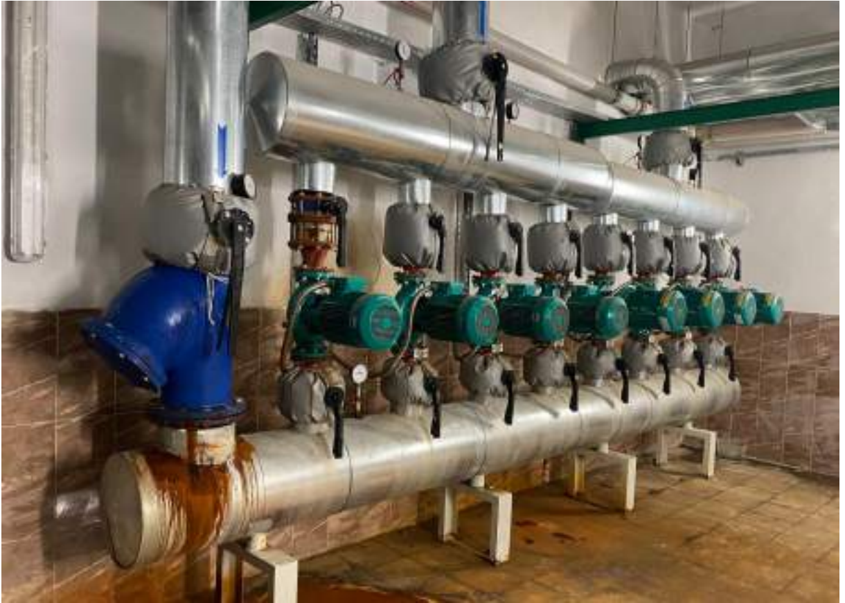
Resim 53. Soğutma Sistemi Pompalar
