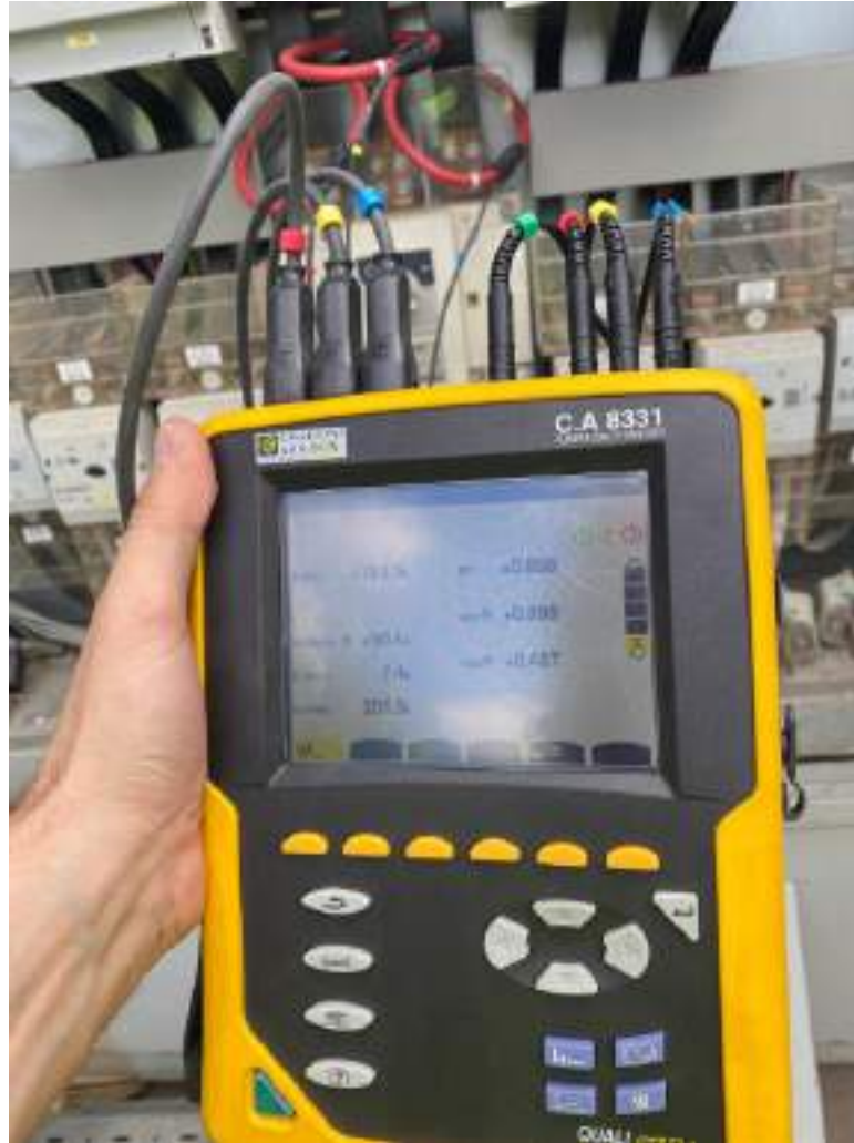
Resim 38. Chiller Enerji Analizörü Ölçümü
