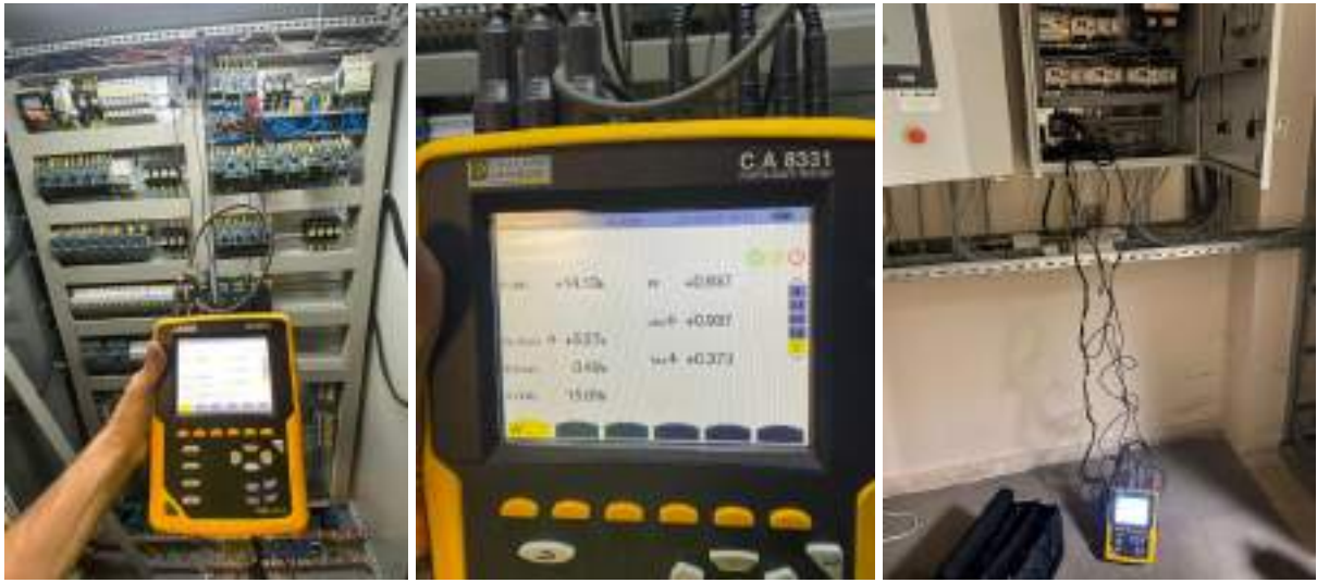
Resim 56. Pompa Enerji Ölçümü
