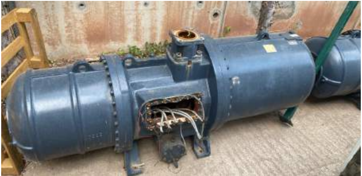
Resim 37. Arızalı Chiller Kompresörü
