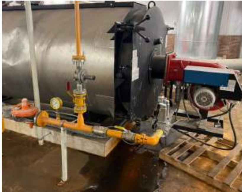
Resim 51. Kazandan Meydaa Gelen Su Kaçağı
